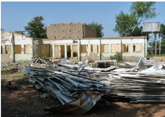
Beschädigte Klinik am EYN Headquarters, Kwarhi
