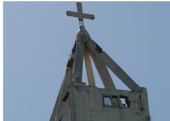
Beschädigter Kirchturm der EYN Kirche in Mubi
